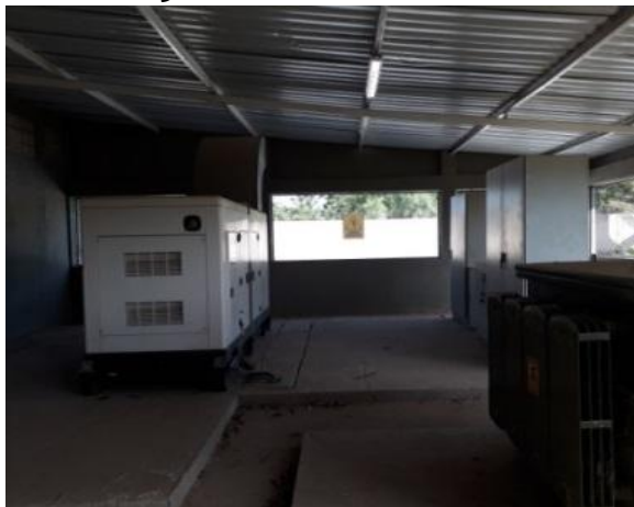
Ilustración 58. Sub – Estación Eléctrica
