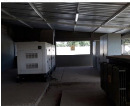
Sub – Estación Eléctrica
